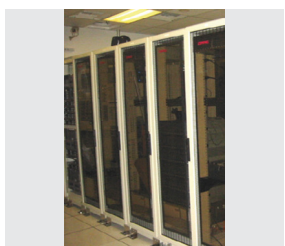
Soportes de servidores informáticos anclados al piso
