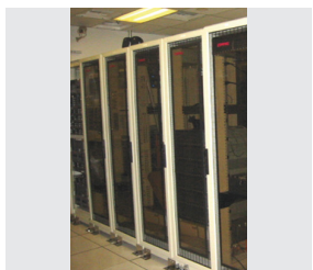
Racks de serveurs informatiques ancrés au plancher
