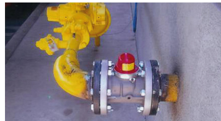
ガスラインの地震用緊急遮断弁
