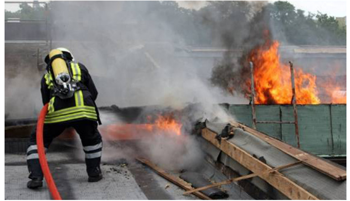
Durch Dacharbeiten ausgelöster Brand
