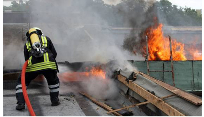
Incendie suite à des travaux d'étanchéité sur toiture
